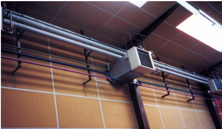
Photo 5.5. Système de chauffage d'un atelier.
